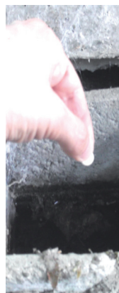
Trattamento delle caditoie private
